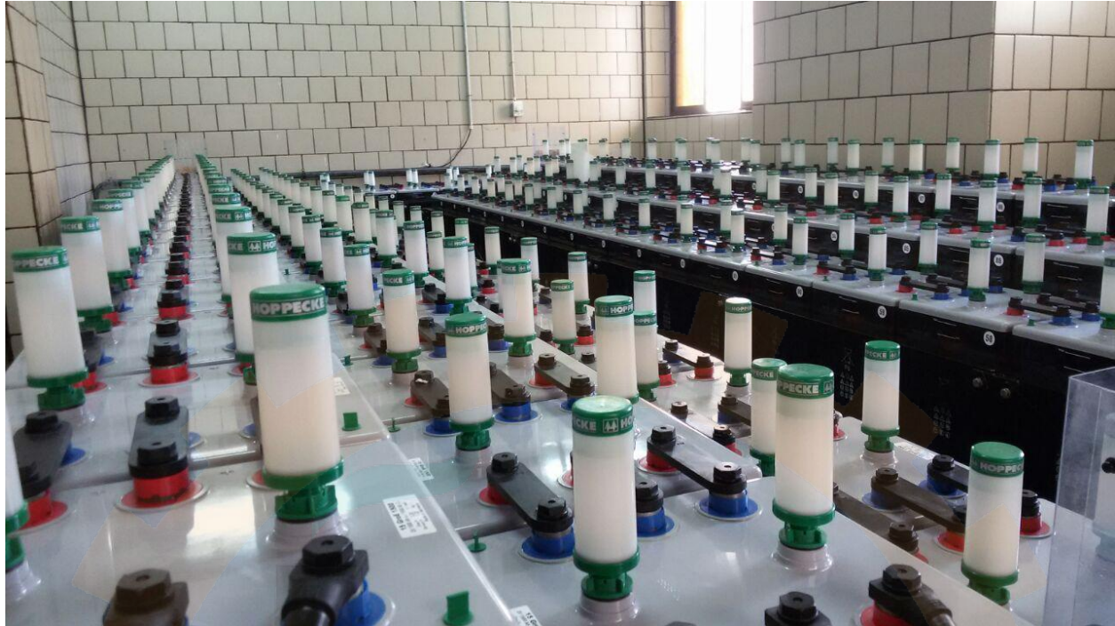
شکل (۱-۱۵) باتری خانه در حال کار - نیروگاه دماوند
