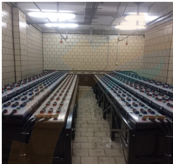
شکل (۱-۶) نمایی از باطری خانه نیروگاه دماوند
