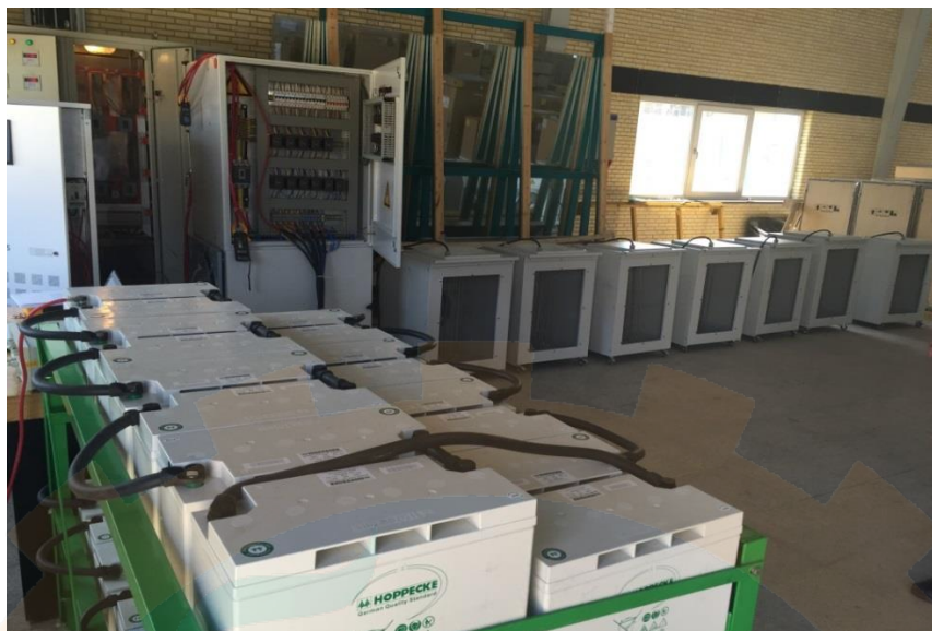
باطری های در حال تست در کارگاه شرکت
